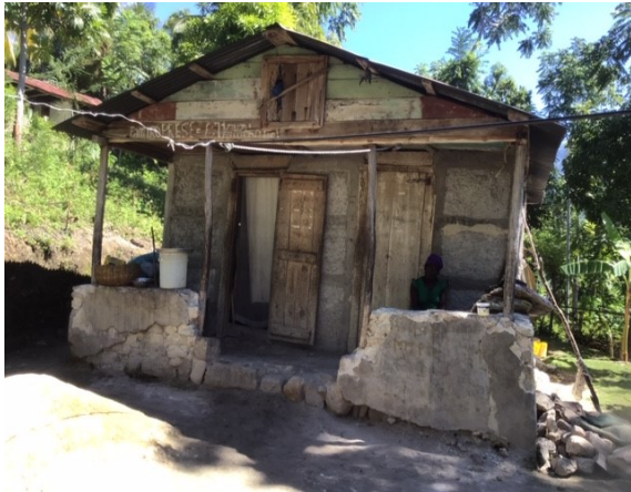
Photo (ci-dessus): La maison de Mme Theodore avant sa réparation - Sept. 2018.
